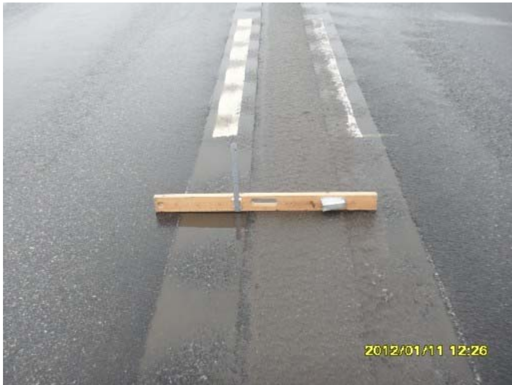
Kuva 9 Vettä jyrsintäurissa Laitilassa 11.1.2012.
