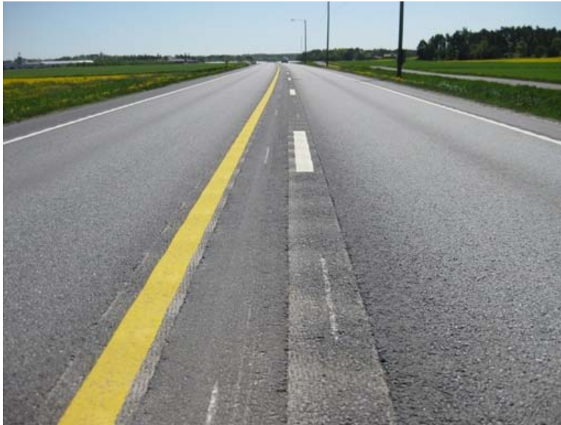
Kuva 1. Laitilan leveän keskimerkinnän koetie. Laitilassa käytettiin sinijyrsintää ja jyrsittiin keskialueelle aina kaksi rinnakkaista pituussuunnassa syvyydeltään vaihtelevaa uraa.
