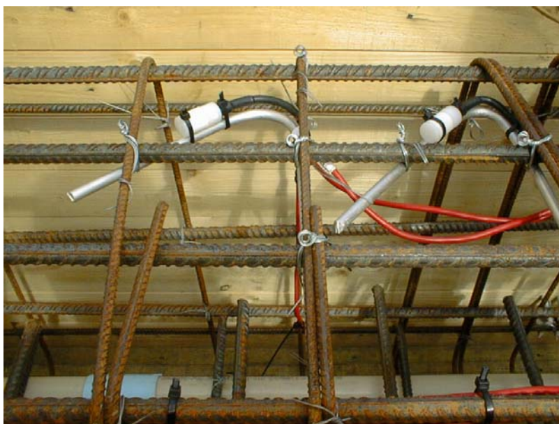
Mitta-anturit reunapalkissa. (VTT) Sensorer i kantbalken (VTT) Sensors in edge beam. (VTT)
