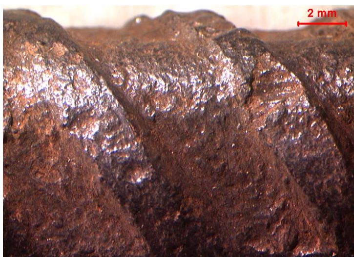
Korroosioasteeseen 3 syöpynyt raudoitustanko, \varnothing 12 mm, teräsharjauksen jälkeen. (VTT) Stålborstad armeringsstång, \varnothing 12 mm, korrosionsgrad 3. (VTT) Wire brushed reinforcing bar, \varnothing 12 mm, corrosion class 3. (VTT)
