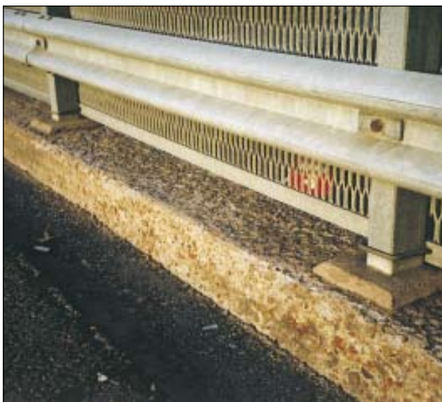
Kuva 1. Talvisuolauksen aiheuttamaa rapautumista reunapalkissa.
