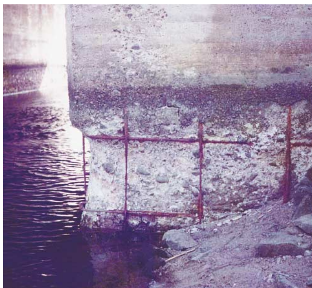
Kuva 1. Laajoja rapautumia on yleensä alusrakenteissa.
