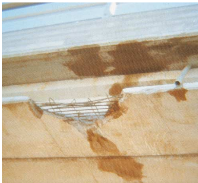
Kuva 2. Törmäysvaurio on korjattava ensi tilassa.
