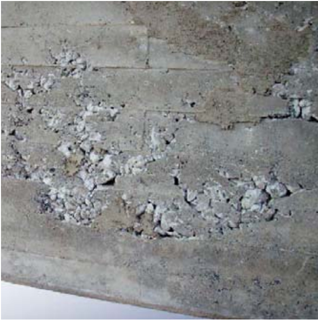
Kuva 1. Ejektoripaikkaukselle sopiva valuvika.
