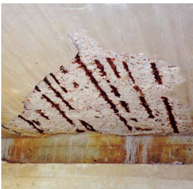
Kuva 2. Betonipeite lohkeaa pois raudoituksen korroosion voimistuessa.
