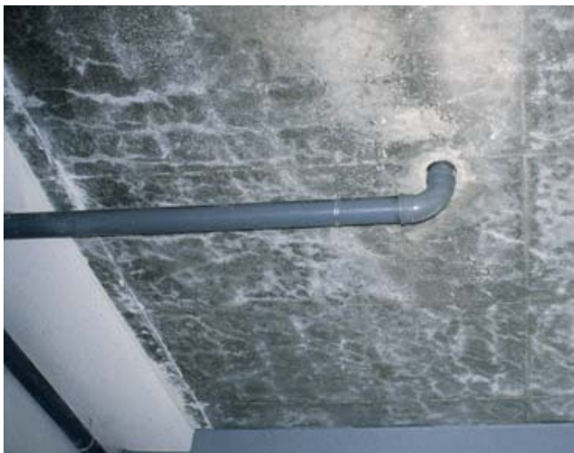
Kuva 1. Betonipeite halkeilee raudoituksen korroosion käynnistyttyä.
