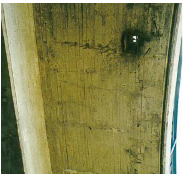
Kuva 2. Vesivuoto halkeaman kautta aiheuttaa seurausvaurioita.
