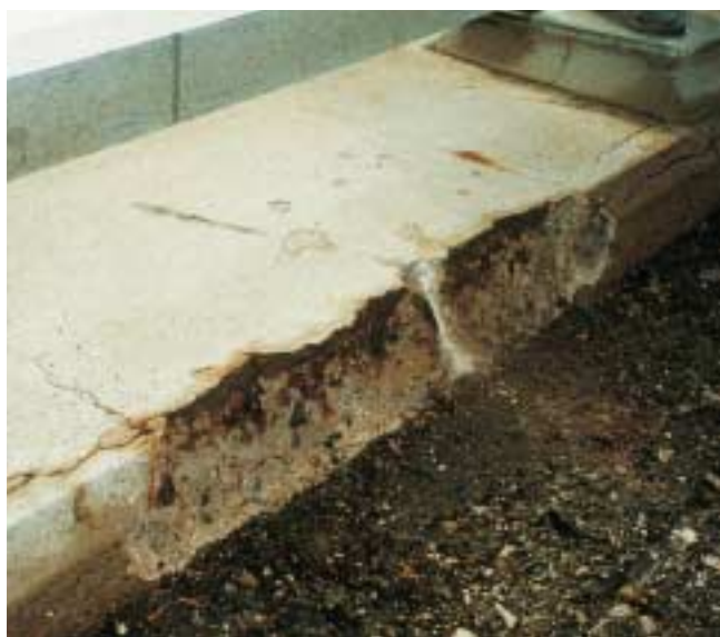
Kuva 1. Korjaamattomat halkeamat edistävät betonin rapautumista ja raudoituksen korroosiota ja aiheuttavat jäätymisvaurioita.
