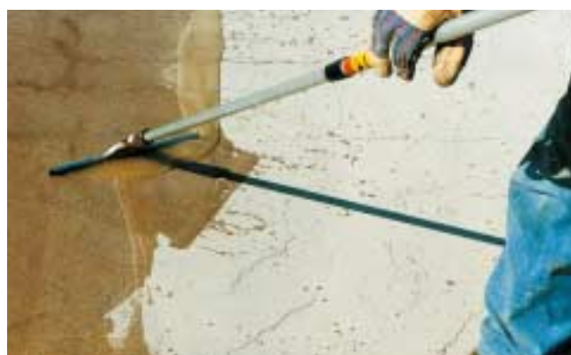
Kuva 13. Halkeilleen pinnan imeytystä ilman halkeamien esikäsitelyä.
