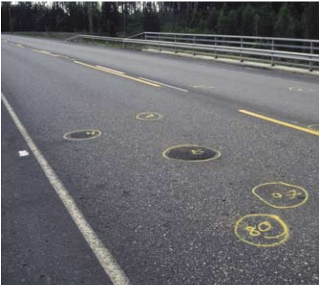
Kuva 1. Höyrystyneen kosteuden aiheuttamia kuplia päällysteessä.
