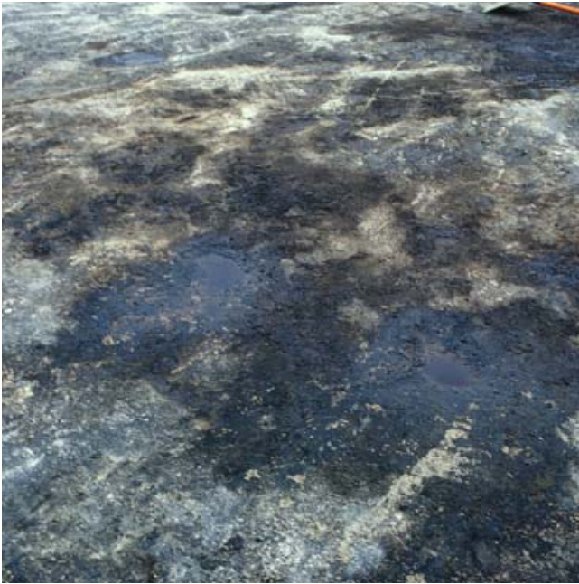
Kuva 1. Öljyä vedeneristyksen alustassa.
