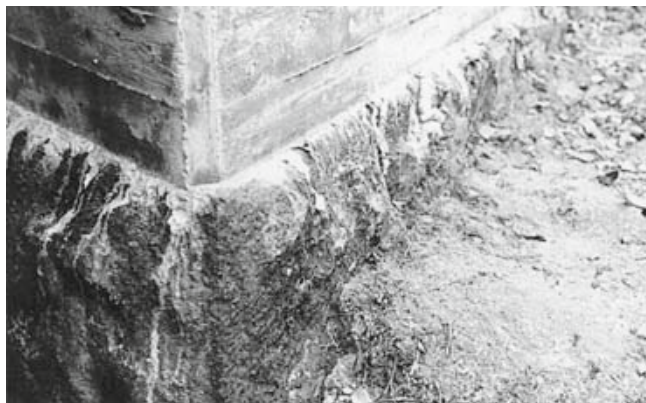
Kuva 9. Sementtiliimaa on valunut kivipinnoille.
