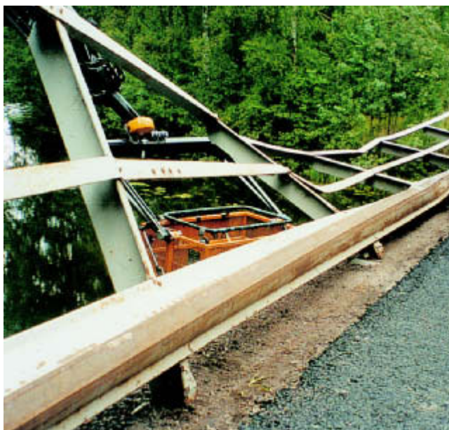
Kuva 1. Törmäyksessä pahoin vaurioitunut kaide.
