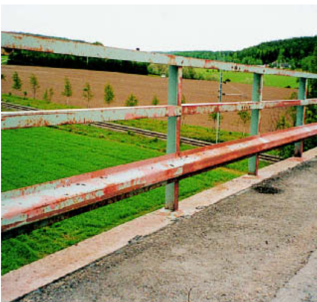
Kuva 2. Kaide ei vastaa nykyisiä vaatimuksia (esimerkiksi L-teräspylväät).
