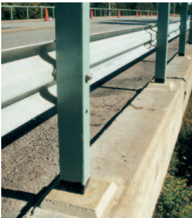
Kuva 3. Esimerkkejä eri tavoin tehdyistä kaidepylvään juuren korjauksista tyypillisine ulkonäkövirheineen.
