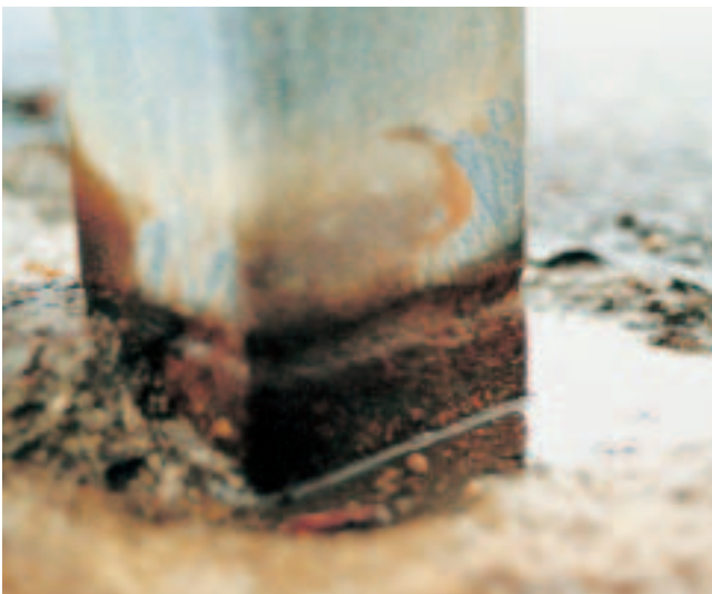
Kuva 2. Kaidepylvään syöpyminen on estettävä, koska se vaarantaa liikenneturvallisuuden.
