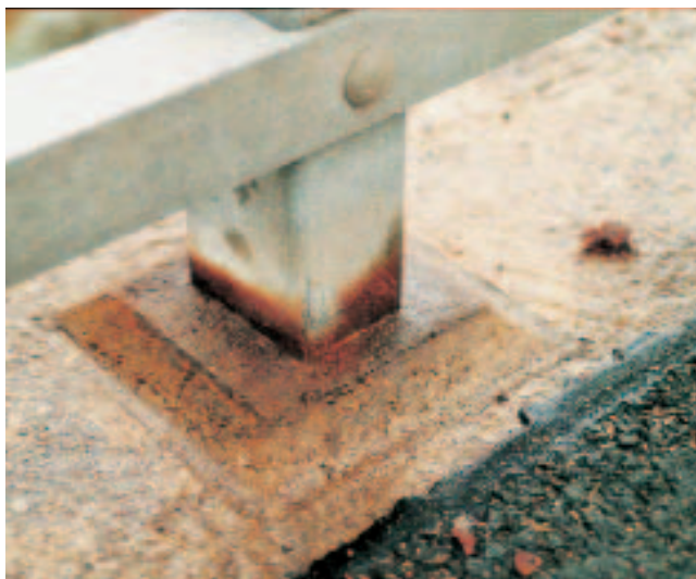
Kuva 1. Vaurioitunut kaidepylvään juuri.
