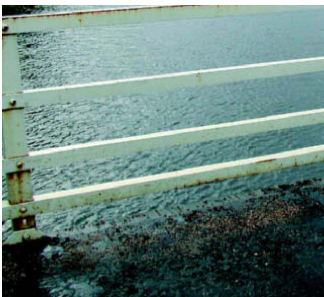
Kuva 2. Maalikerroksen alla on kauttaaltaan ruostetta, joten paikkausmaalauus ei tule kysymykseen.
