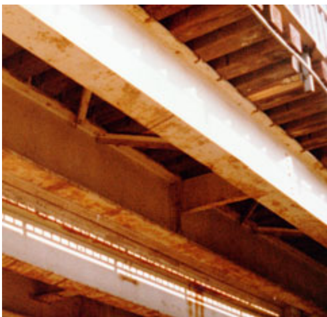
Kuva 1. Etualalla olevan palkin alapinta on ruostumisasteessa Ri3 ja taaempana olevat ruostumisasteessa Ri4.
