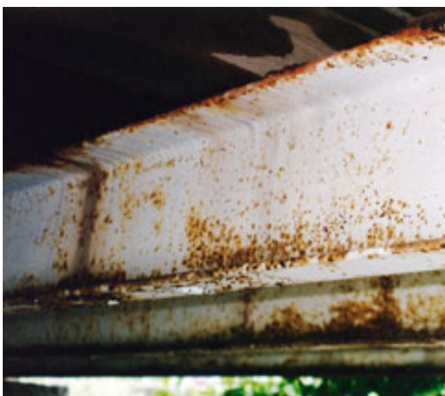
Kuva 2 Ruostumisaste Ri4 (pistemäistä korroosiota).
