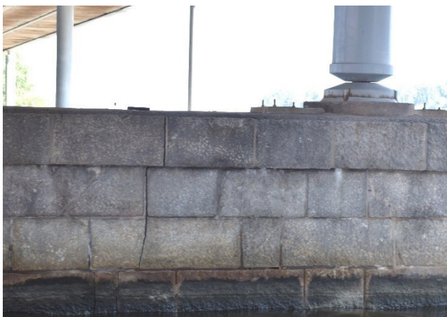
Kuva 1. Halkeamia kivisessä välituessa.
