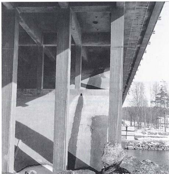
Kuva 1. Vesi valuu syöksytorvesta holvin päälle.
