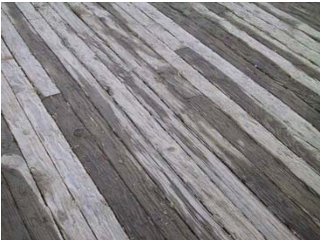
Kuva 1. Naulattu puukansi, jossa on kulumaa, ravistumista ja pintalahoa.
