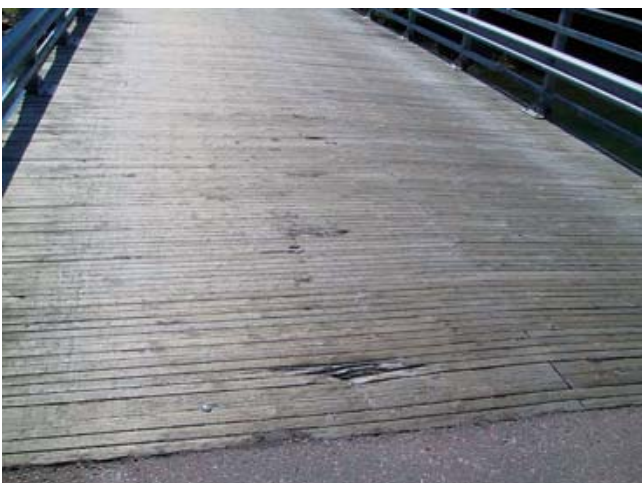
Kuva 2. Päällystyskelpoinen vaurioluokan 2 puukansi.
