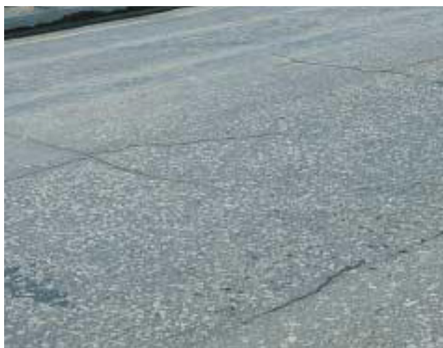
Kuva 1. Avonaiset halkeamat muodostavat vaurioitumisriskin alapuolisille rakenteille.
