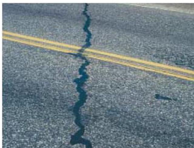
Kuva 2. Korjatun halkeaman kuntoa on seurattava ja mahdolliset vauriot on korjattava ensi tilassa.
