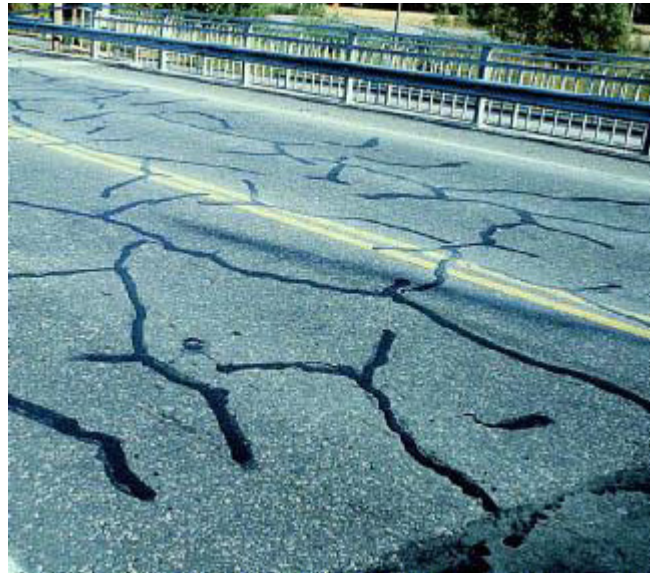
Kuva 7. Asfalttipäällysteen halkeamien sulkeminen (kuumana levitettävä, massatyyppi N2). Tämä sillan päällyste tulisi uusiksi halkeamien määrän vuoksi.
